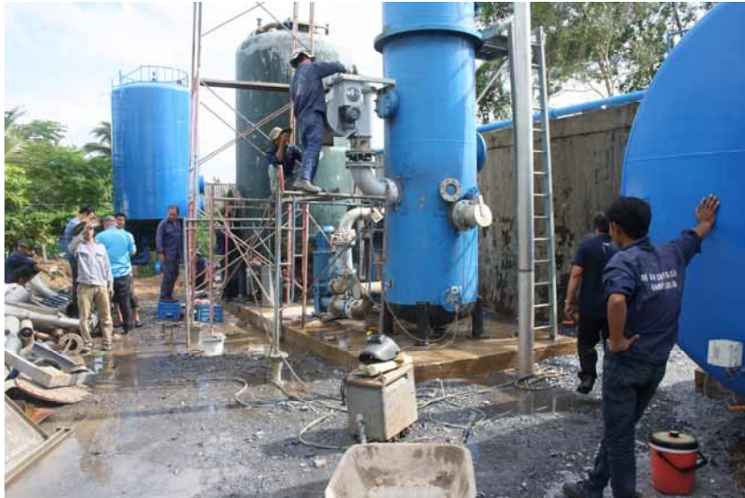
De in bedrijf genomen ontmanganingsinstallatie
