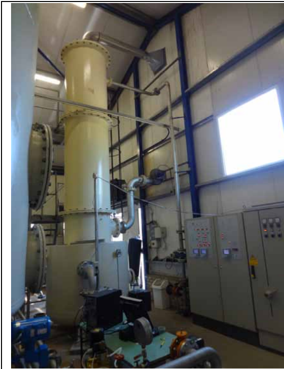
Foto drinkwaterinstallatie voor arseenverwijdering in Backi Vinogradi.
